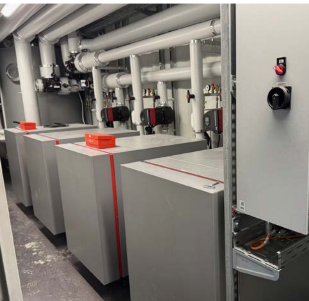
Die Energiezentrale mit vier Wärmepumpen ist ein wichtiges Element für die CO 2 -Neutralität des Lackierbetriebes.
